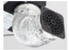
吸気部ダクト
